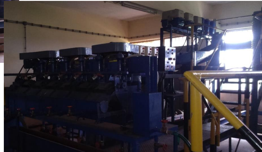
Vue des bacs de flottation
